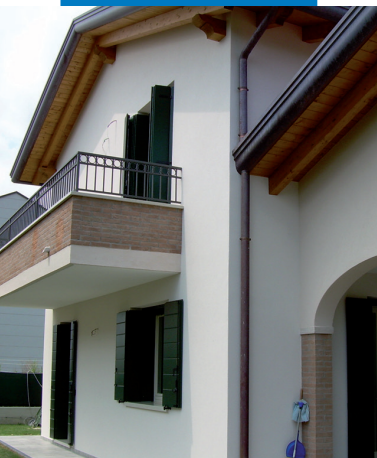
Reggio Emilia - Ιταλία - Εργασίες σε ιδιωτική κατοικία, όπου χρησιμοποιήθηκε το Mapetherm AR1 GG
