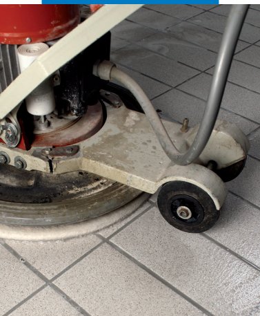
Καθαρισμός επιφανείας με νερό και περιστροφική μηχανή μονής κεφαλής με ειδικούς δίσκους λείανσης, όπως "Scotch-Brite"
